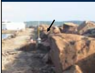
防波堤を被覆する岩石が転落
