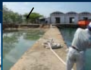
背後が吸い出された護岸
