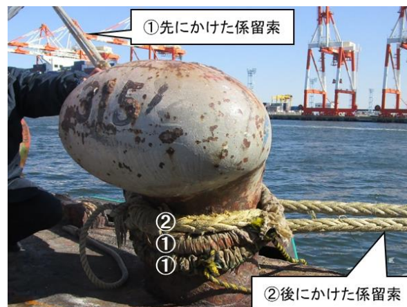
写真-3.1 中抜きをしている係留索の事例
