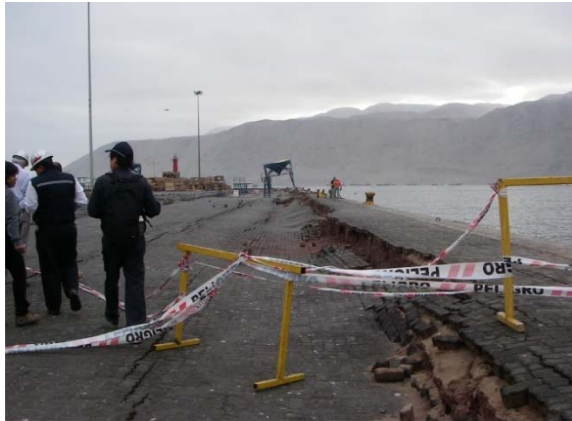
写真-3 地震被害（イキケ港・ふ頭の不等沈下）
