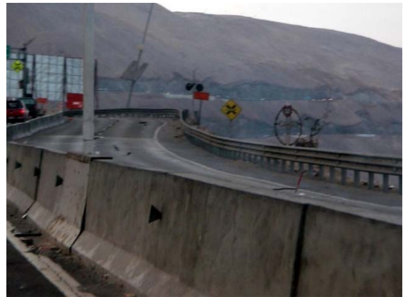
写真-4 地震被害（イキケ市郊外・幹線道路法肩崩れ）
