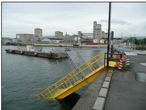
写真－3 渡橋の落橋被害（坂出港）
