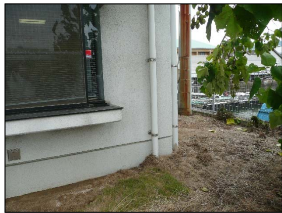
写真－4 越波による浸水痕跡（坂出港）
