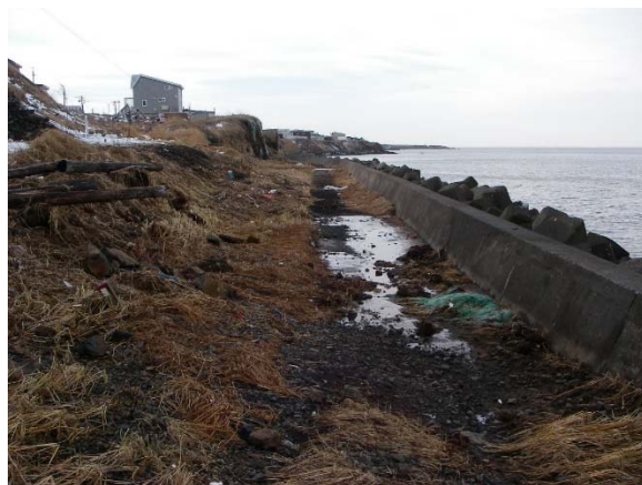
写真－５ 海岸保全施設（護岸）陸側での土砂の散乱 (岬町地区海岸)
