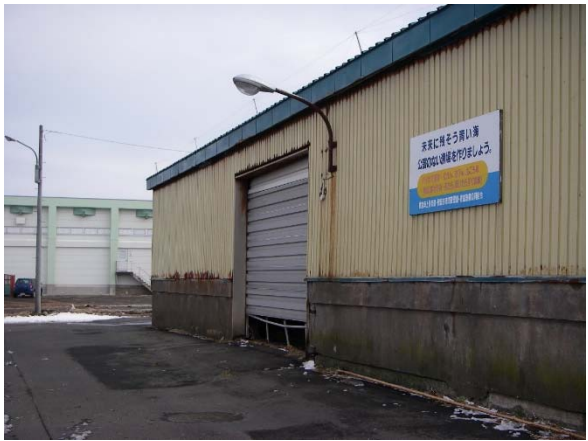
写真－４ 港湾上屋の扉の破損 (海岸町 1 丁目)
