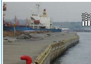
被災事例（岸壁のはらみ出し）
