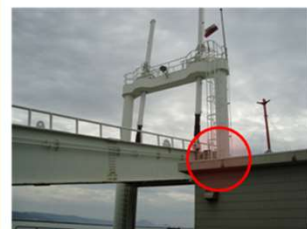
可動橋被災箇所
