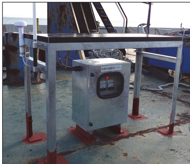
写真-2 自立電源式 AIS 装置の設置状況
