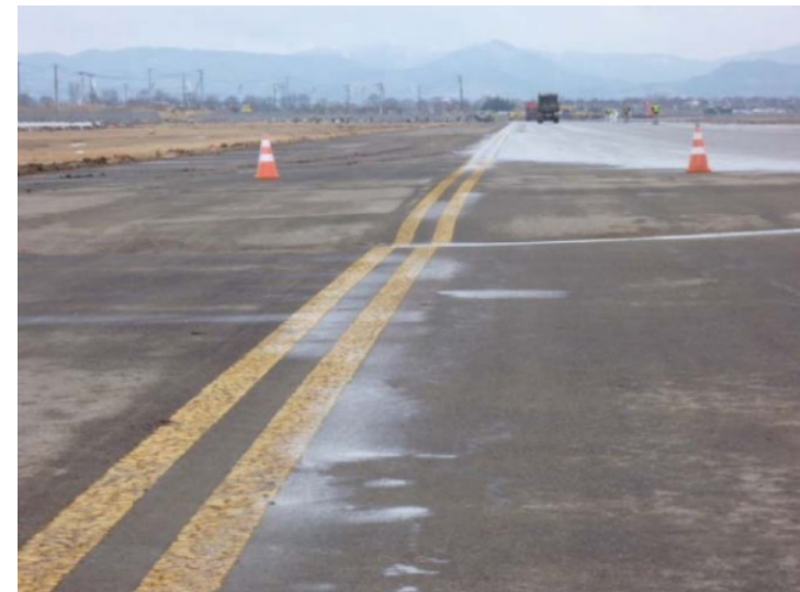
液状化による誘導路の局所沈下
