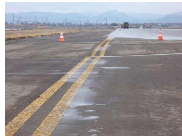
路面標識の乱れ
