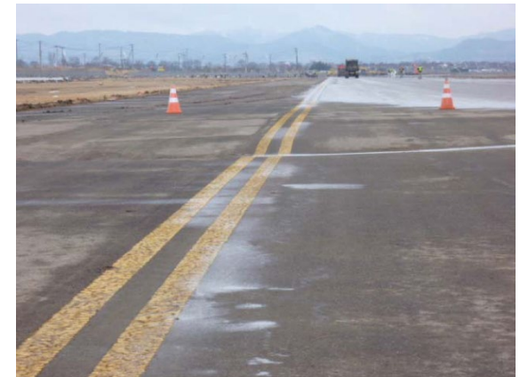
路面標識の乱れ
