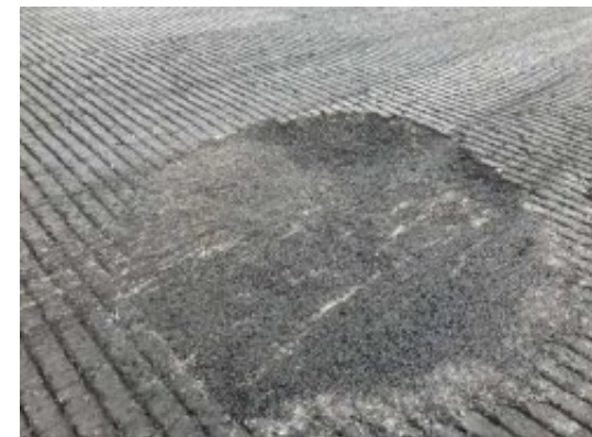
施工直後に、航空機荷重による 塑性変形が生じた応急復旧箇所
