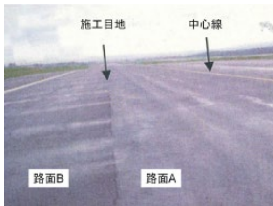
図Ⅱ-4.1 開いた施工目地から雨水が浸入している状況
