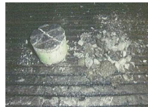
舗装内部の砂利化
