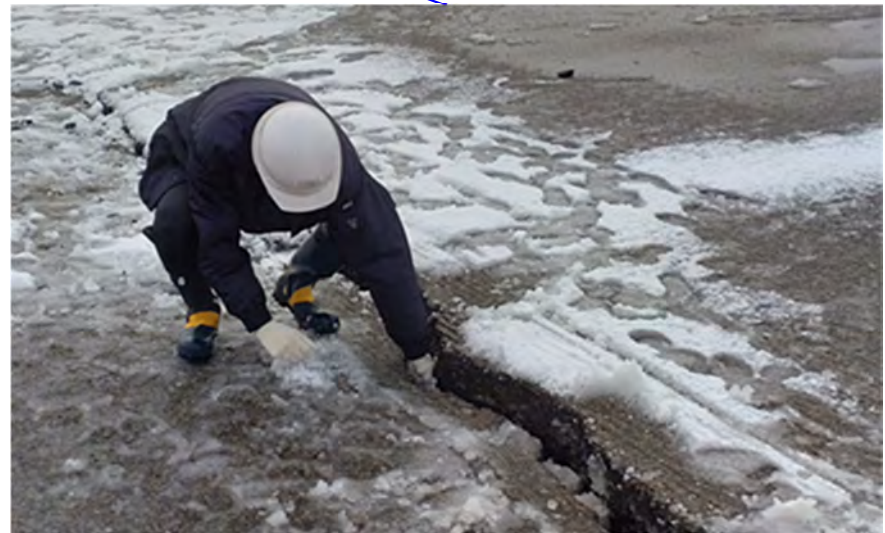
最大15cmの段差が発生
