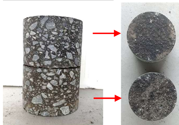
層間剥離のコア
