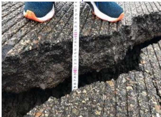
最大15cmの段差が発生
