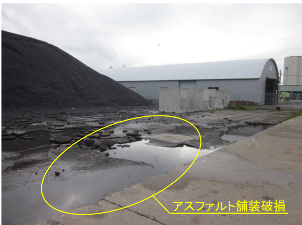
写真-4.10 網走港における浸水後の状況
