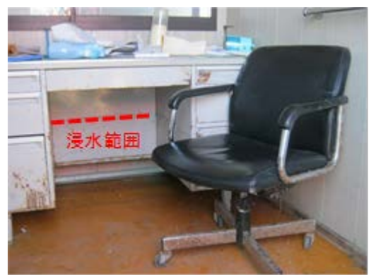
写真-2.11 西浜町③（事務所内）
