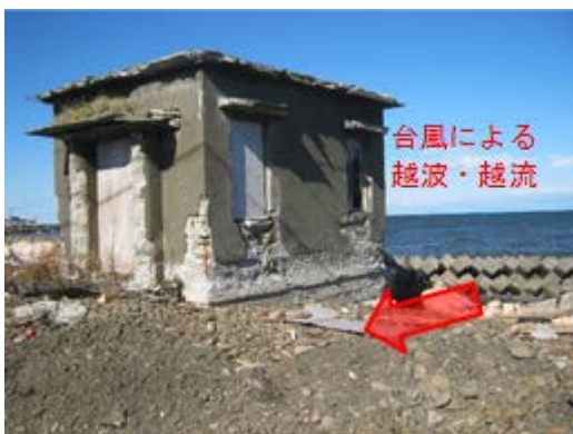
写真-2.9 西浜町①（護岸欠損箇所）
