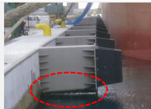
図 4.16 防舷材の鋼製の台座
