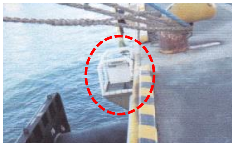
図 4.23 岸壁上や側面に突出した岸照灯
