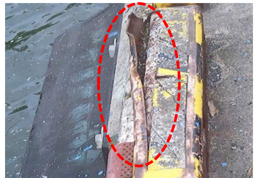
図 4.36 鋼材が腐食した車止め
