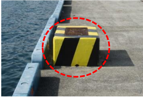
図 4.27 岸壁上に突出した給水設備
