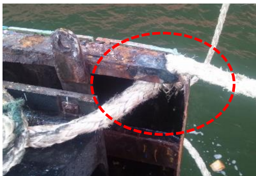
図 4.33 腐食した受衝板
