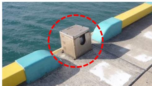
図 4.25 岸壁上に突出した電源ボックス
