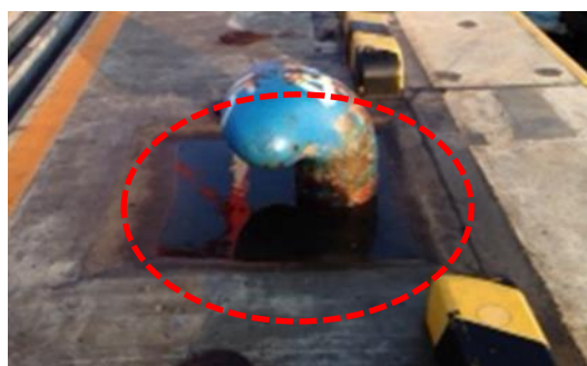
図 4.3 係船柱周りの段差②
