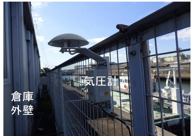
写真-B.5 気圧計 (敷地フェンスに設置)
