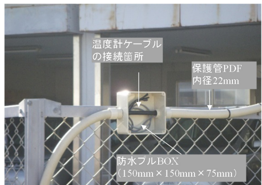
図-4.15 温度計ケーブルの接続箇所
