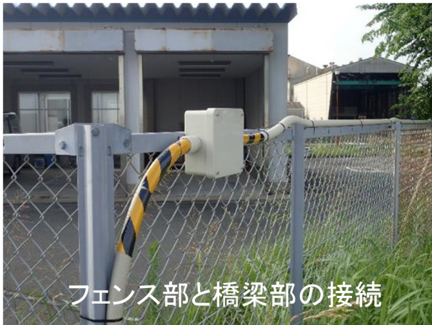
写真-B. 7 ケーブル接続部
