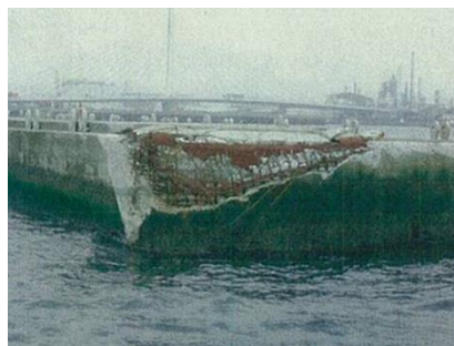
(b) ケーソン（重力式岸壁）の損傷
