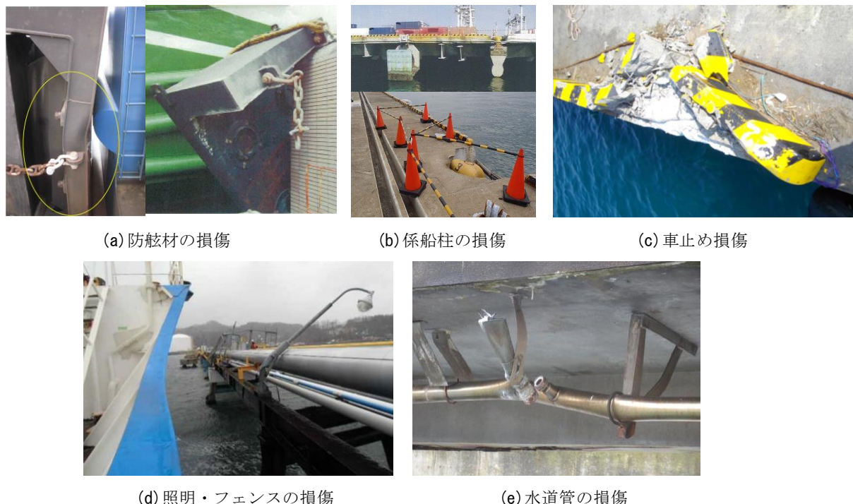
写真-3.2 付帯設備の代表的な損傷事例 1)
