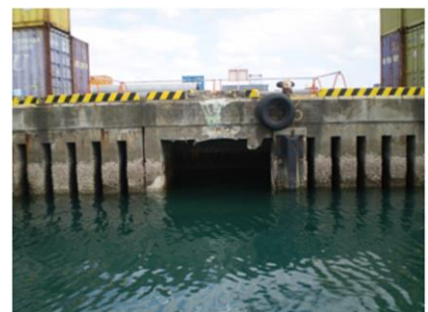
(c) スリット構造の損傷
