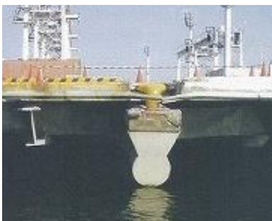
(a) 栈橋の鋼管杭の損傷
