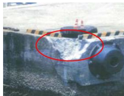
(e) ケーソン（重力式岸壁）の損傷
