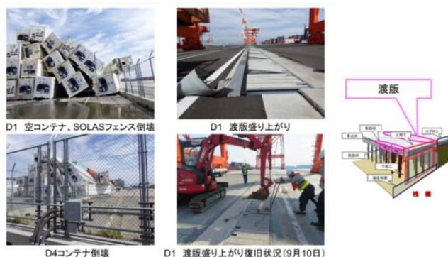
写真-A.2.7 被災状況写真 7) (横浜港・本牧ふ頭 D1 バース・D4 バース)
