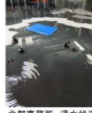
北部事務所 浸水状況
