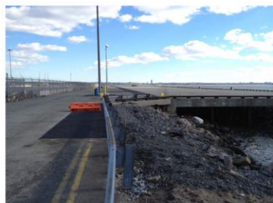
写真-A.2.15 被災状況写真 12) (護岸の被災)
