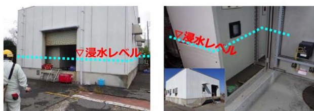
受電所の浸水(床上約30cm)
