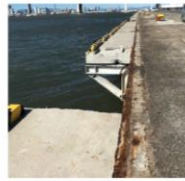
T-5岸壁一部損傷
