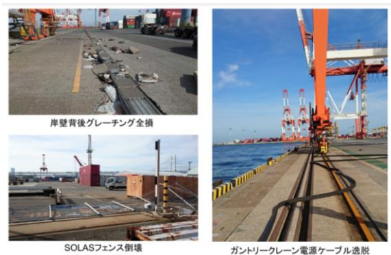
写真-A.2.6 被災状況写真 7) (横浜港・本牧ふ頭 BC 突堤)
