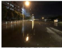
臨港道路 冠水状況
