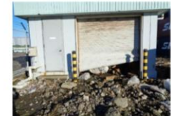
マリnhaus倉庫(川崎市)の破損
