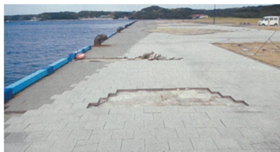
写真-5.6 台風による上部工表面部材の損傷の事例
