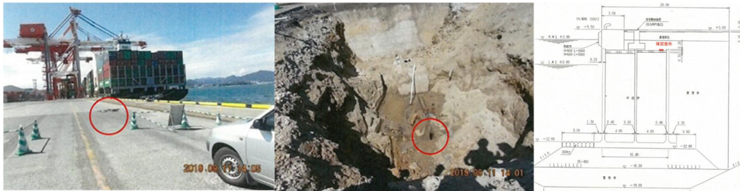
写真-5.1 ケーソン中詰材流出の事例
