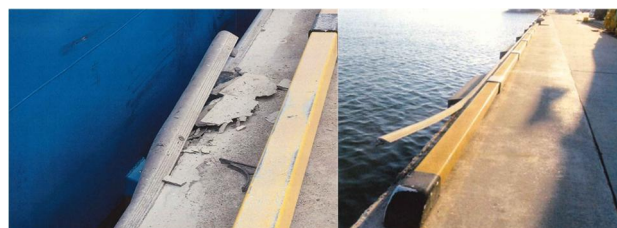
写真-5.11 コーナー材損傷の事例
