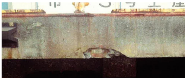
写真-5.5 船体衝突による上部工側面の損傷事例
