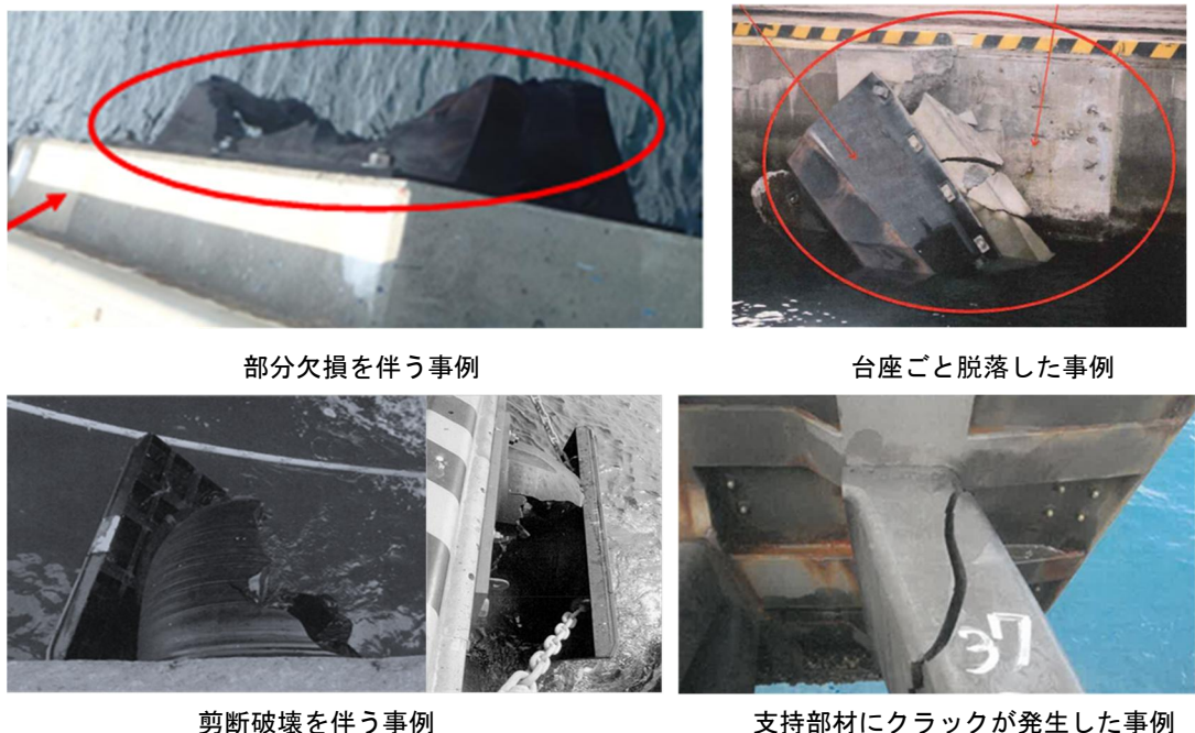
写真-5.8 防舷材損傷の事例
