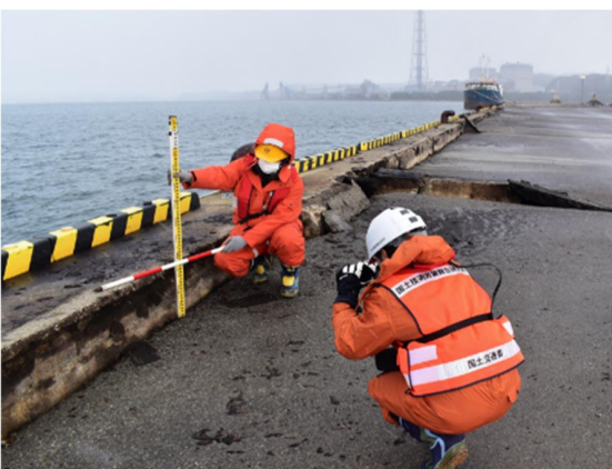
令和6年能登半島地震における被災状況調査（七尾港）
