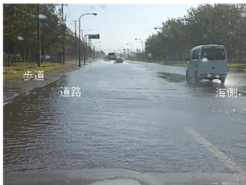
写真2-4 臨港道路釧路西港道路東向き(10月2日9:19頃)
