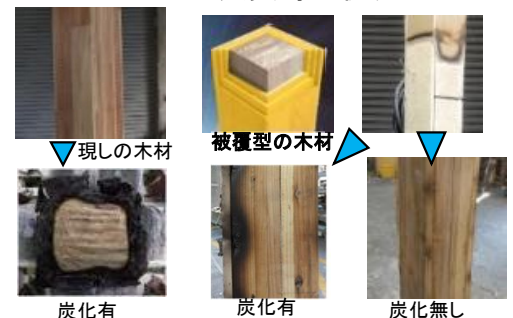
火災後の構造部材状況
