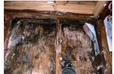
含水率が高くなり腐朽した外壁の内部（築6年）
