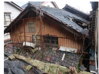
保安上危険な状態の空家の例
