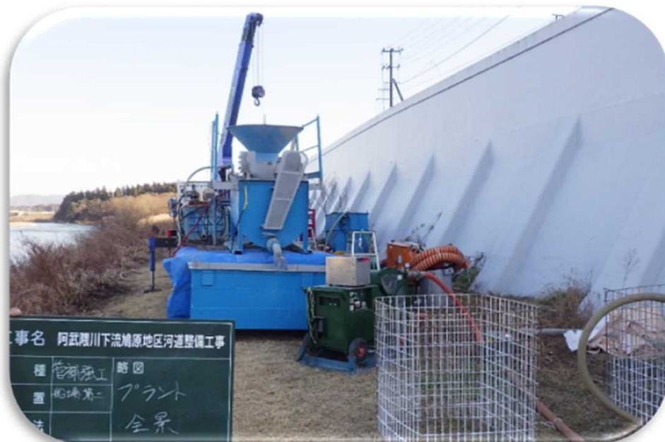
モルタル製造プラント
