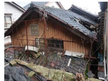
保安上危険な状態の空家の例
